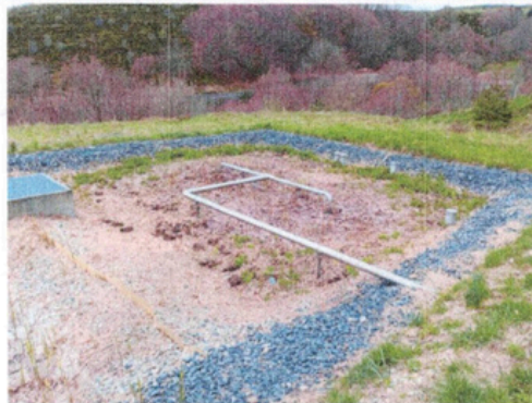
Vues du bi-filtre planté de roseaux
