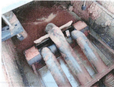
Vue de la bâchée d'alimentation du bi-filtre planté de roseaux
